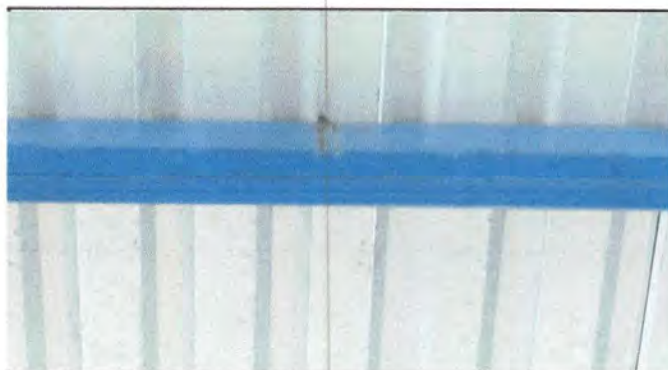
Foto 4: Sustrucción de lámina dañadas.
